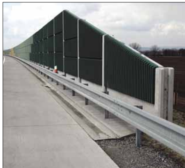
Protihluková clona na dálnici D1 u Mořic
